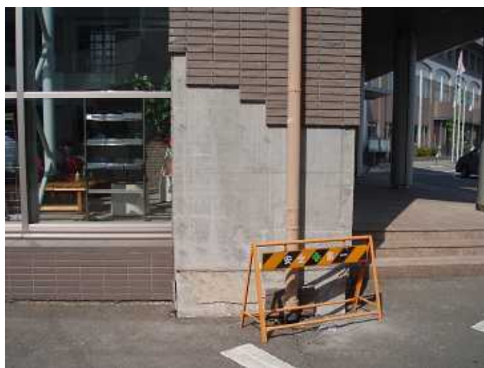
写真 7.3 栗原市役所の柱のタイル落下、柱下の地盤が 3cm 程度沈下
