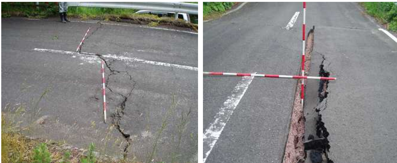
写真 7.7、7.8 道路に発生した亀裂（栗駒ダム付近の都田地区）
