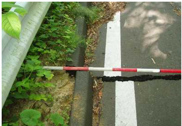
写真 7.11 道路亀裂、横ずれの状況
