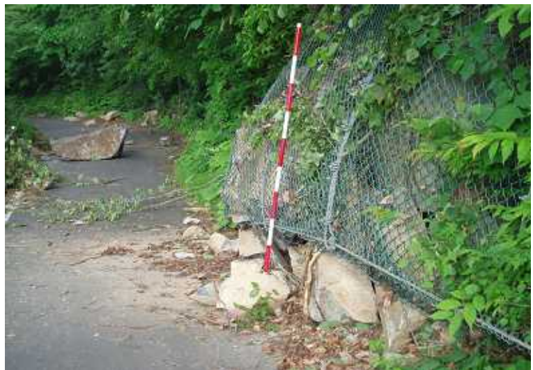
写真 7.9、7.10 落石の状況とロックネット部の落石状況
