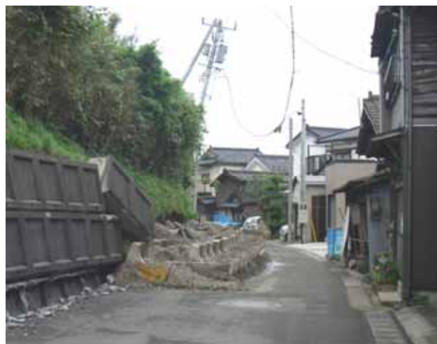
写真 4.3.12 大型ブロック積擁壁の倒壊
