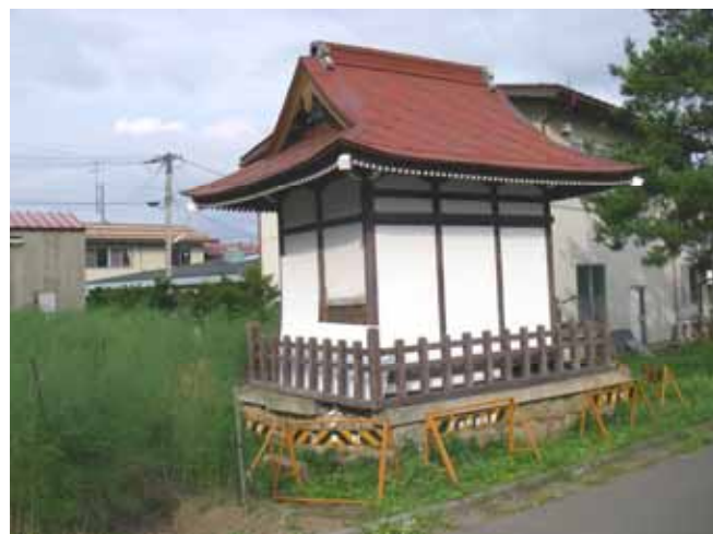
写真 4.2.7 三水庁舎裏のお堂の被害
