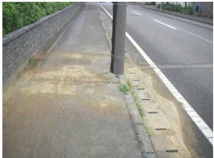
写真 4.3.7 液状化による噴砂の跡
