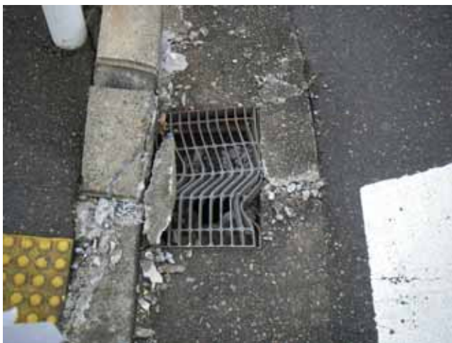
写真 4.3.19 地震による排水柵の蓋の損傷
