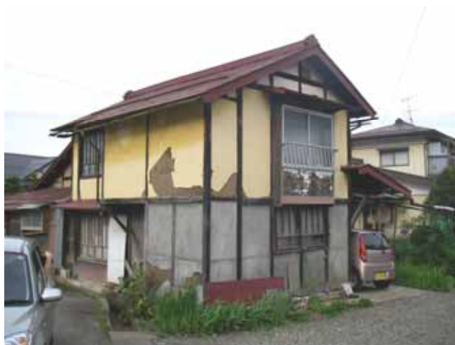
写真 4.2.6 外壁の剥落（芋川地区）
