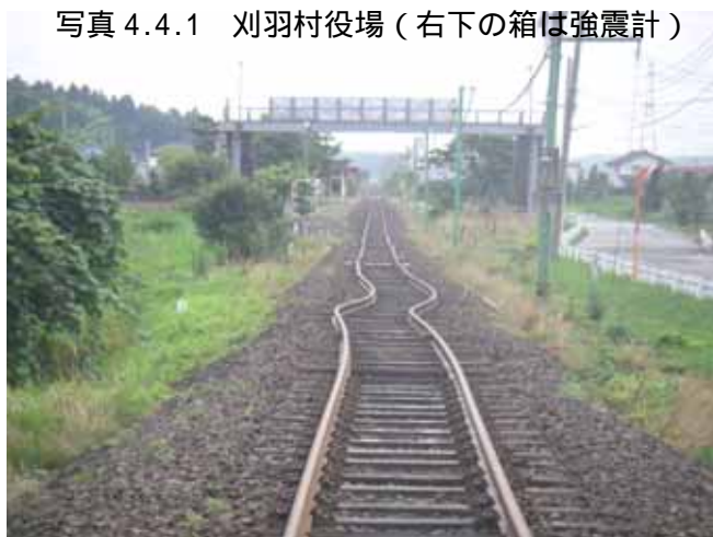
写真 4.4.3 刈羽駅付近の線路が蛇行
