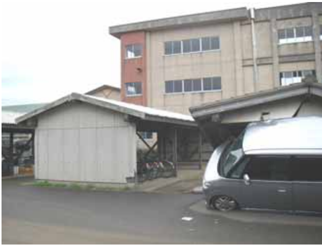
写真 4.3.5 駐輪場の倒壊 (左のスレート屋根は倒れず、右の瓦屋根のみ倒壊)
